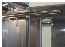
Inklusive Rohrbahnanlage mit einer Verlängerung
